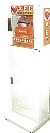
AEDの施設設置状況
