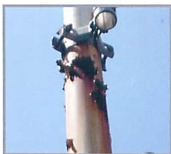
支柱が腐食している
