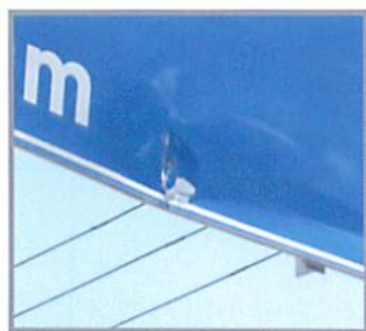
標識板が破損している
